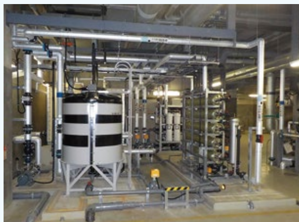
▲井水処理設備
