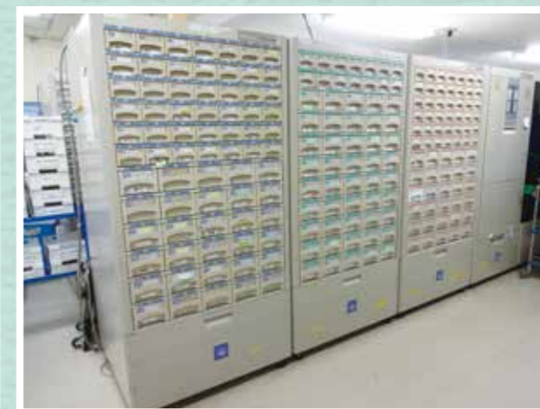
注射薬自動払出システム
